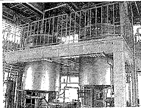
石根工場内に設置したブライインの製造および充填設備
