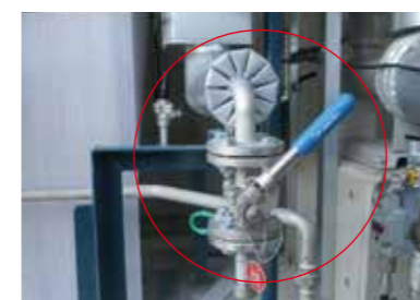
バルブ開閉において意図しない弁の動きを未然に防止する“スプリングリターンバルブ”を導入しました。
