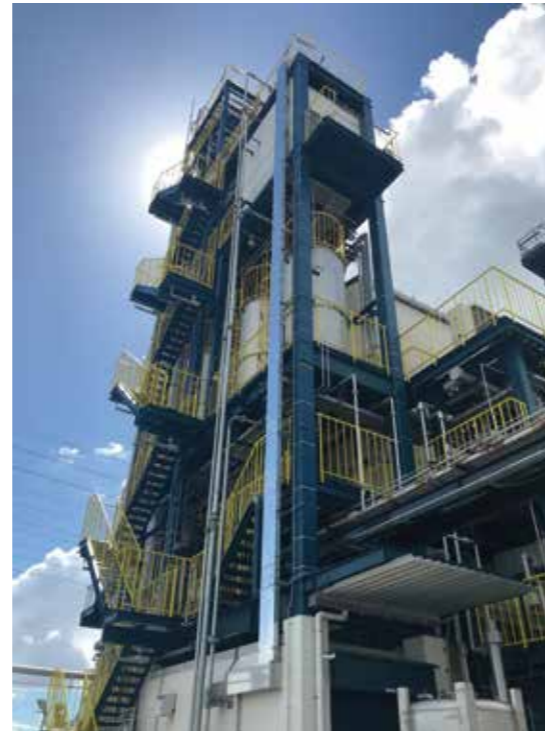
新蒸留塔 (V設備)
